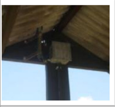
Ny internettantenne og bedre utstyr montert. Nå med trådløst signal til alle deler og enheter på området.
